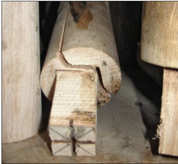
2007. Vervanging van gebarsten spillen van de wieg. Let op de scheur in 't verlengde van de pen, als gevolg van de foute wiegconstructie. (Foto Luc Verachtert)
