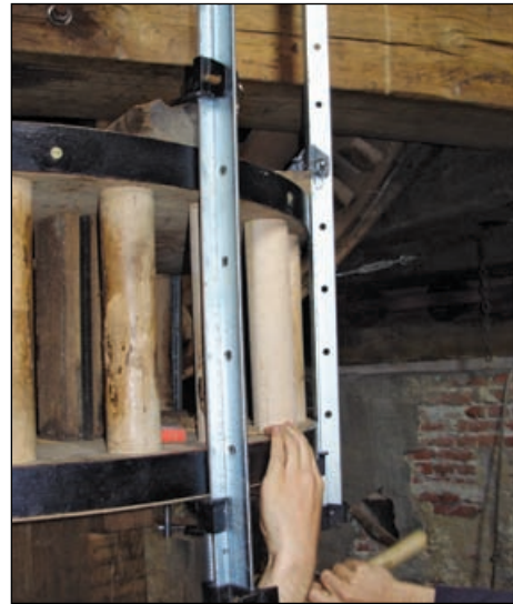
2007. Vervanging van gebarsten spillen van de wieg. (Foto Luc Verachtert)
